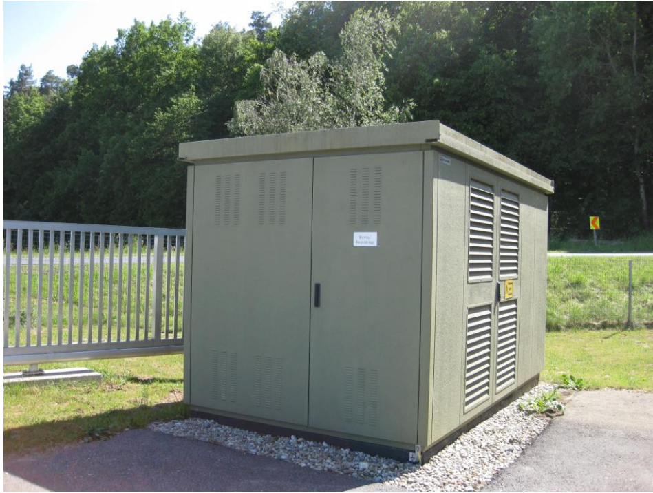
Abb. 5: Trafostation der BGA Hauptmann mit angeschlossenem Fernwärmenetz
