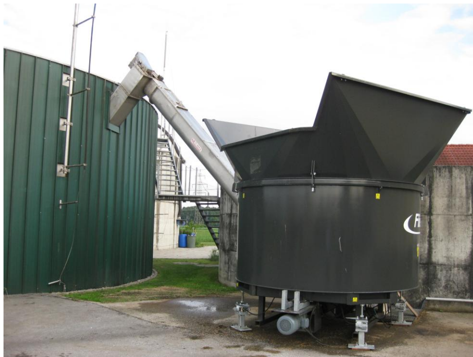
Abb. 2: Befüllstation der BGA Assinger
